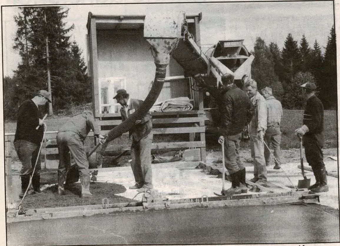
Fredag ble det støpt dansegulv foran scenen der trekkspillfestivalen avvikles, på Sloratun ved Lysern.
