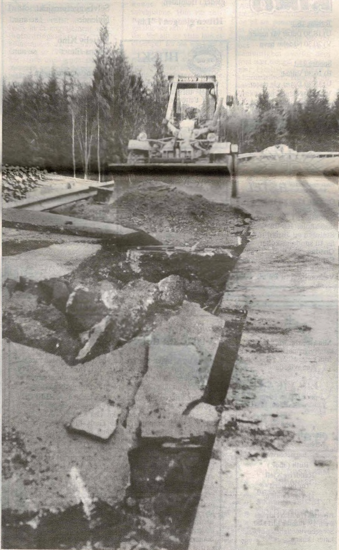
Stadige reparasjoner på den nye veien over Holtskogen p.g.a. setninger i grunnen. Fem millioner har prosjektet kostet.
