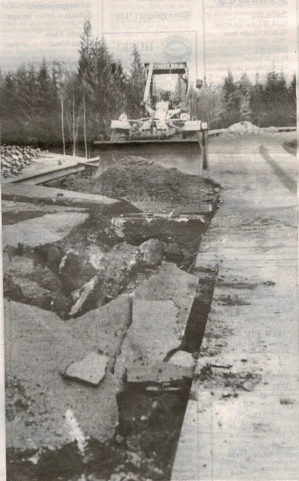
Stadige reparasjoner på den nye veien over Holtskogen p.g.a. setninger i grunnen. Fem millioner har prosjektet kostet.
