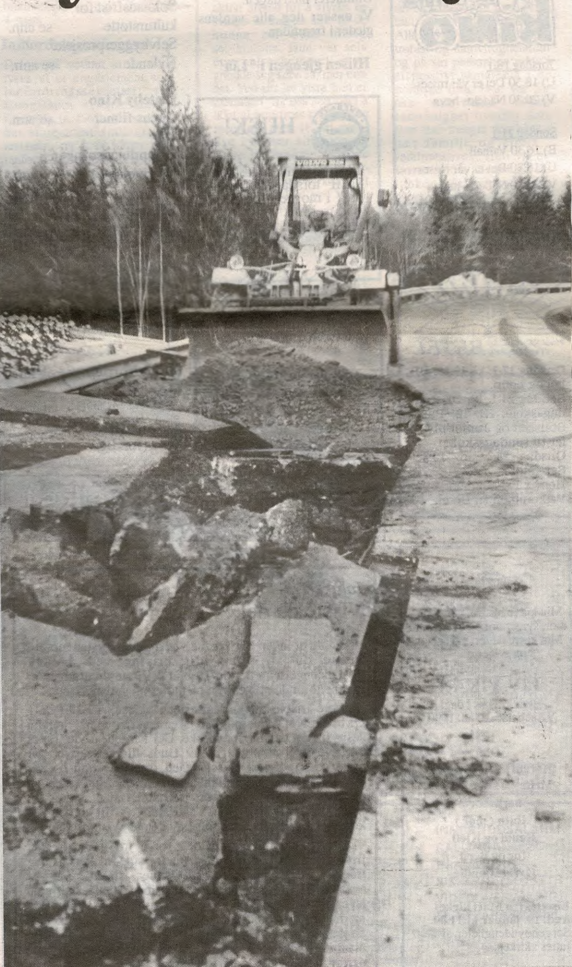
Stadige reparasjoner på den nye veien over Holtskogen p.g.a. setninger i grunnen. Fem millioner har prosjektet kostet.
