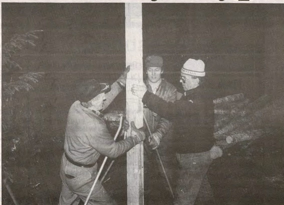
IL Drivs lysløype er snart klar for sesongen, etter iherdig dugnadsinnsats i helga. Her er fra v. Nils Wiik, Jan Bognerud og Egil Sæther i gang med montering av lysmaster.
