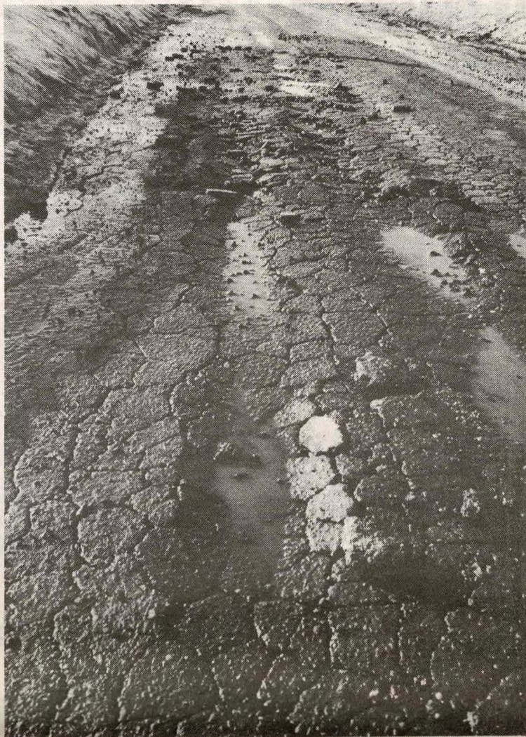
Ekstreme forhold har forårsaket «krakelert» asfalt på store deler av de kommunale veiene som er asfaltert.
