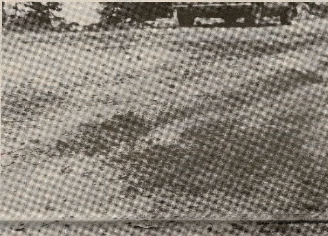
Opprusting av Ødegårdsveien tar nesten halvparten av beløpet som er satt av til investeringer i 85. Her er et skrekkeeksempel på hvordan veien kan se ut på vårparten. . . .
